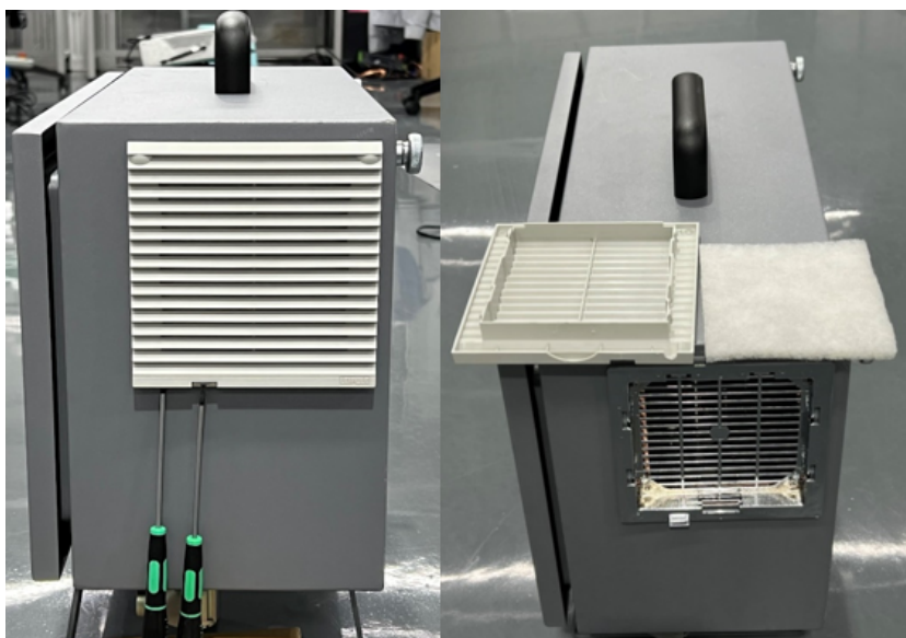
图 2-3: 控制柜过滤器拆装
