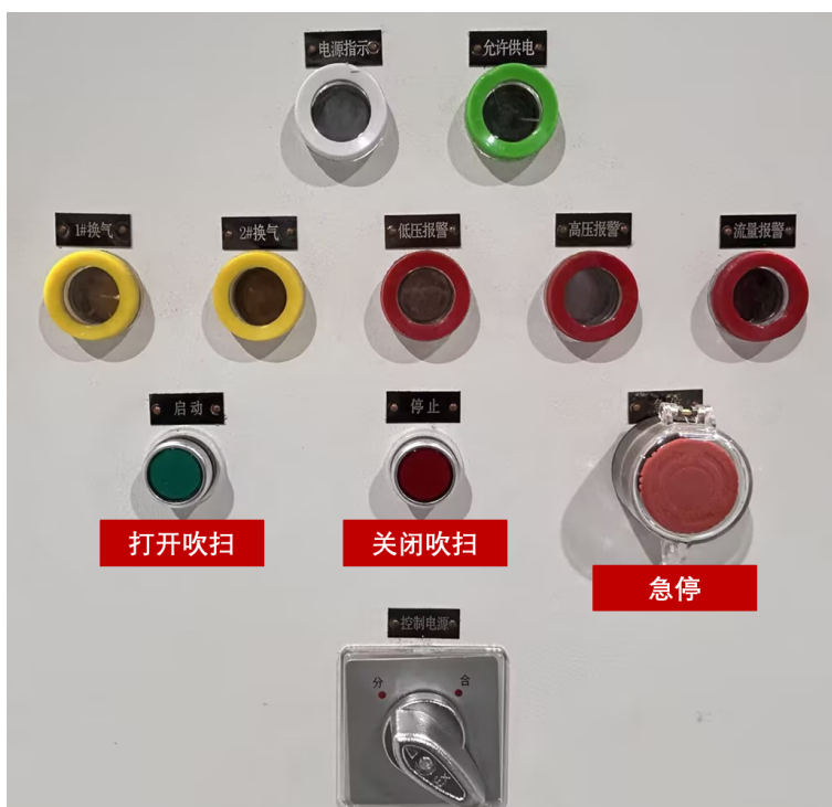
图 3-14: 隔爆腔正压系统控制面板
