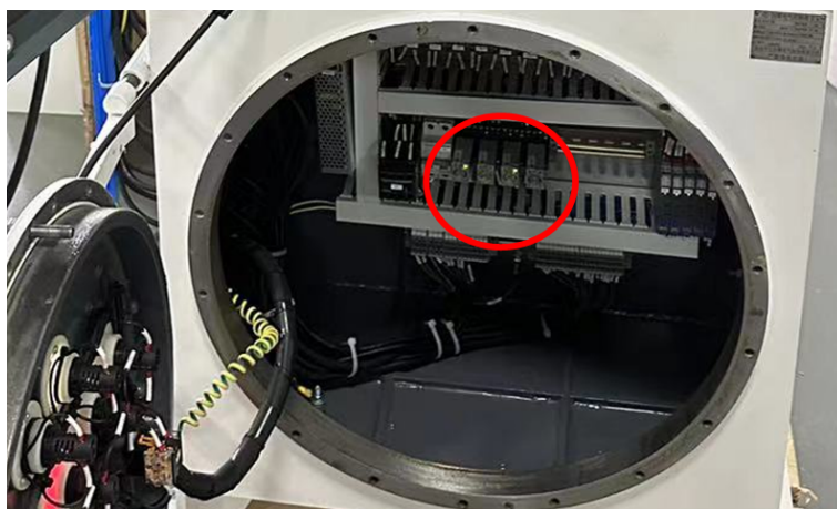
图 3-16: 隔爆腔正压控制系统内部
