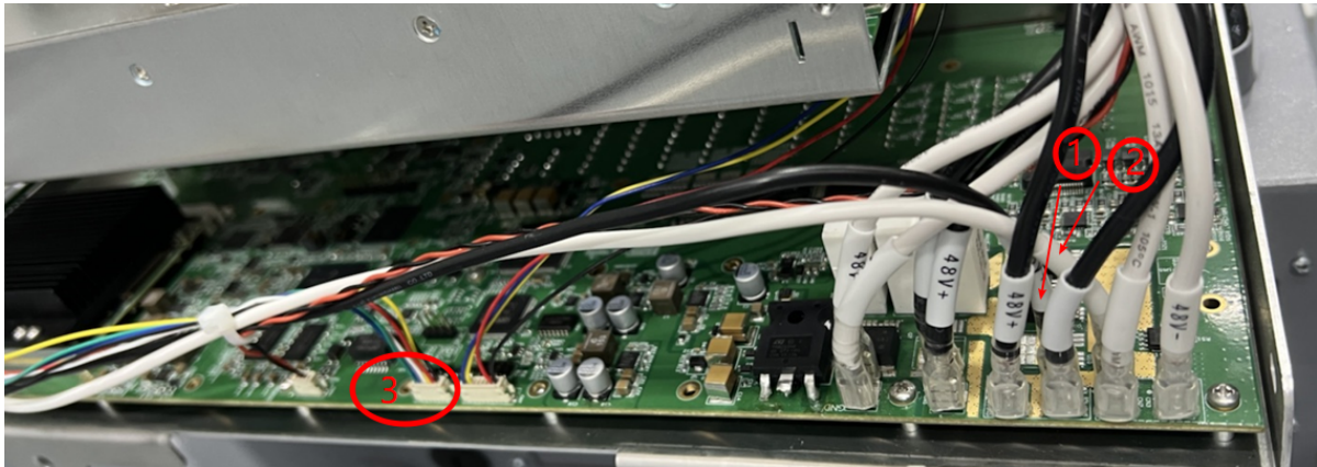
图 3-28: 刹车板到 Safe I/O 的线缆位置
