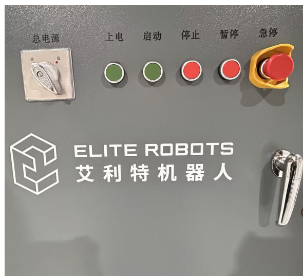
图 3-11: 正压室控制面板
